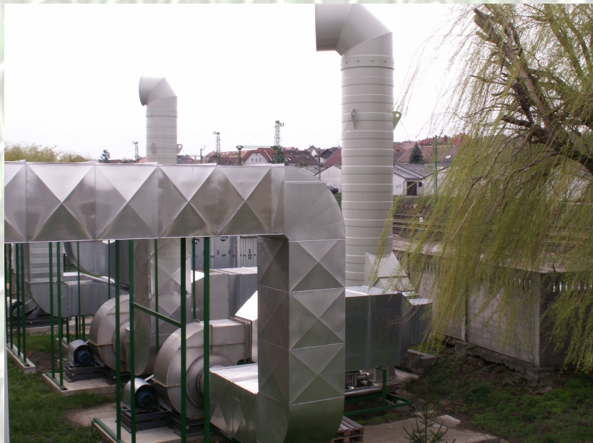
Külső telepítésű komplex légelszívó rendszer
