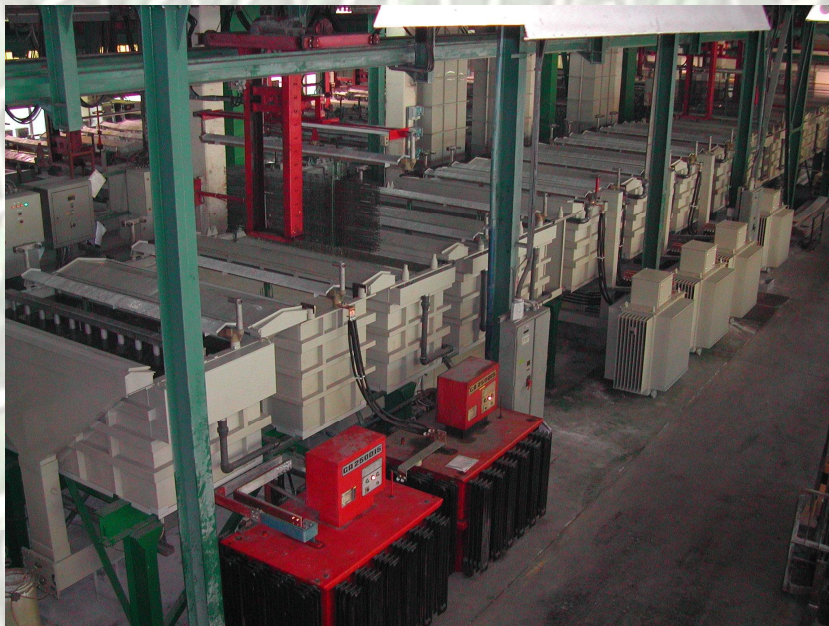
Felületkezelő sor (Elzett Sopron Felületkezelő Kft.)
